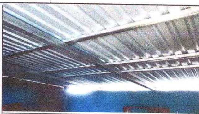
No. 8 sustitución de techo de cocina por deterioro
